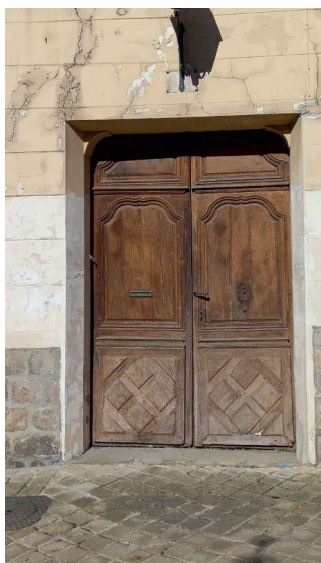
Menuiserie de porte à conserver
