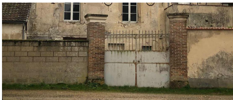
Clôture en blocs de parpaings inadaptée cour du Couvent Picpus
