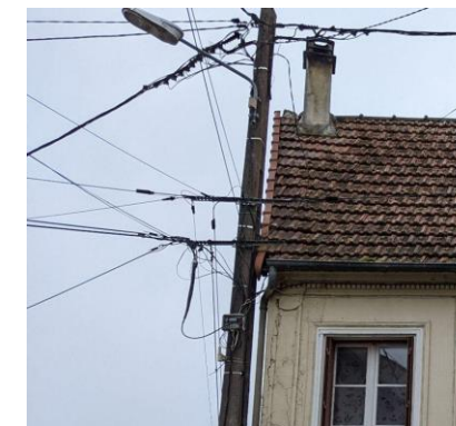
Réseaux aériens rue du Pot d'Etain
