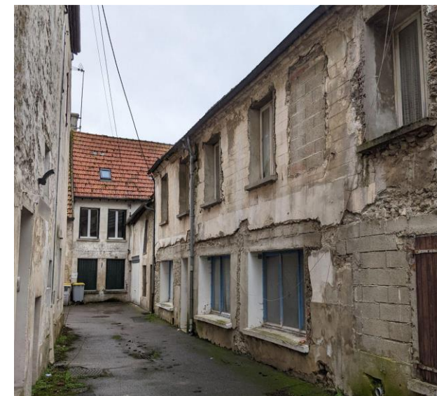
Bâti très dégradé, 9 Grande Rue / cour de la Petite Ferme
